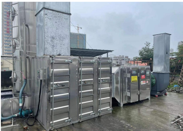
烘干、喷漆废气处理设施
