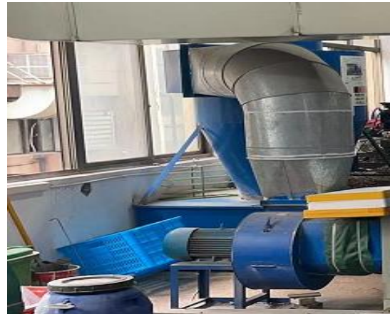
抛光粉尘处理设施
