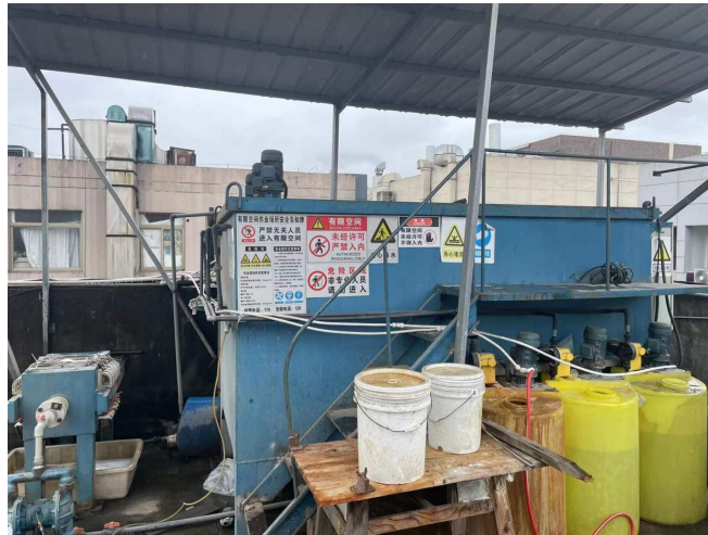
图 3-2 废水处理设施现场照片
