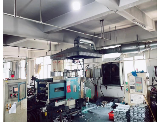
压铸废气收集装置
