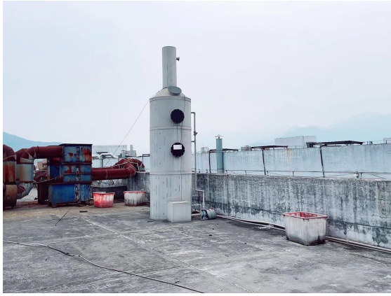
压铸废气处理设施
